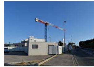
MÉDIPÔLE Nouveau bâtiment et parking pour le person
